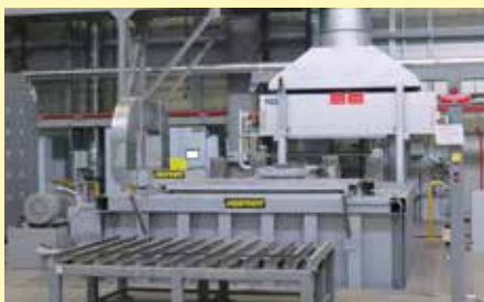
Bac de trempe à l'huile OAB 67000 avec échangeur de chaleur et contenant 67 000 litres d'huile
