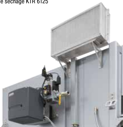
Énergie gaz direct sur une étuve de séchage
