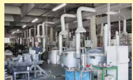
Brûleur à système de récupération sur fours de fusion d'aluminium 16 x TBR 110/12 et 2 x TBR 180/12
