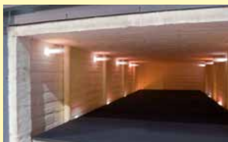
Intérieur du four équipé de huit brûleurs grande vitesse
